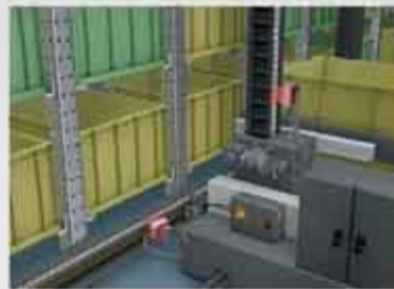
物流仓储系统输送机构的位置与速度测量
